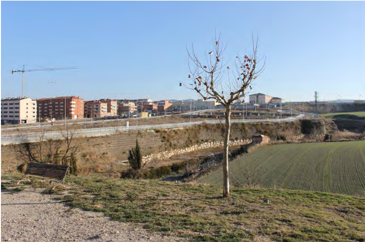
Fotografia 7: Estructura de contenció de terres a la marge esquerre del torrent de can Lledó que ha patit moviments en el trasdós.
