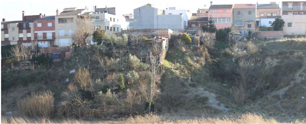
Fotografia 4: marge esquerre del torrent de les bruixes, amb processos d'erosió actius i degradació de les construccions.
