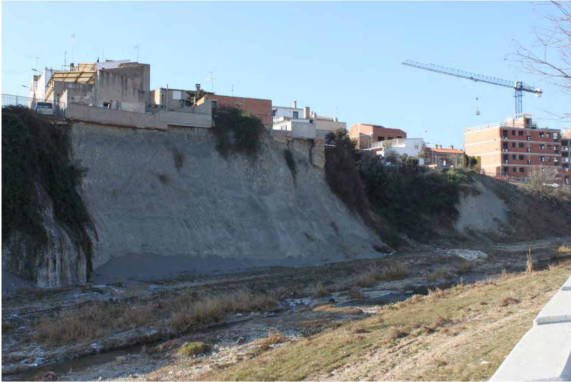
Fotografia 1: processos d'erosió del talús del marge dret del riu Anoia al barri del Pi.
