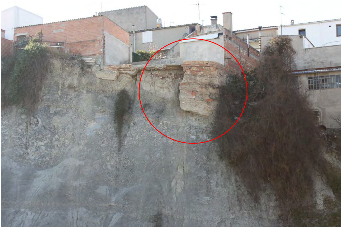
Fotografia 3: detall de deteriorament d'un mur per efecte del retrocés del talús amb perillositat de despreniment alta.
