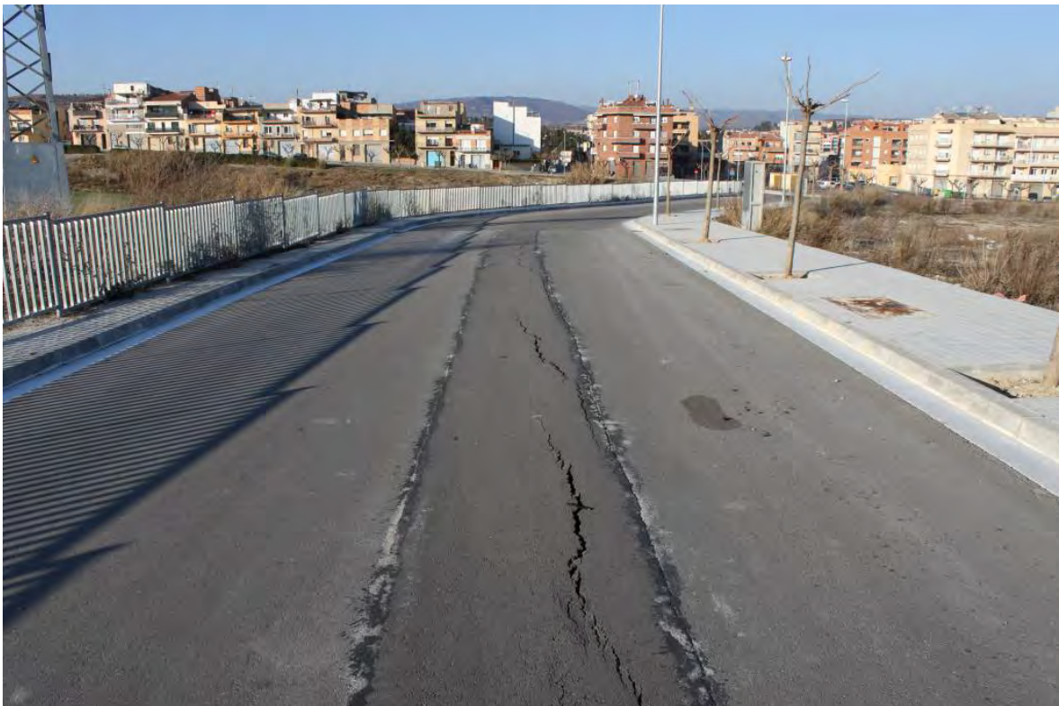
Fotografia 6: esquerdes sobre el paviment del sector del torrent de can Lledò.
