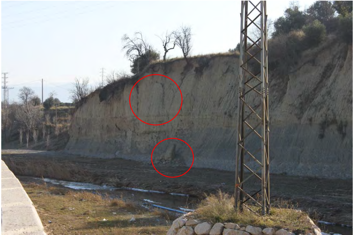
Fotografia 2: detall dels processos d'erosió del talús del marge dret del riu Anoia al barri del Pi, en el cercle despreniments recents i obertura de llastres .
