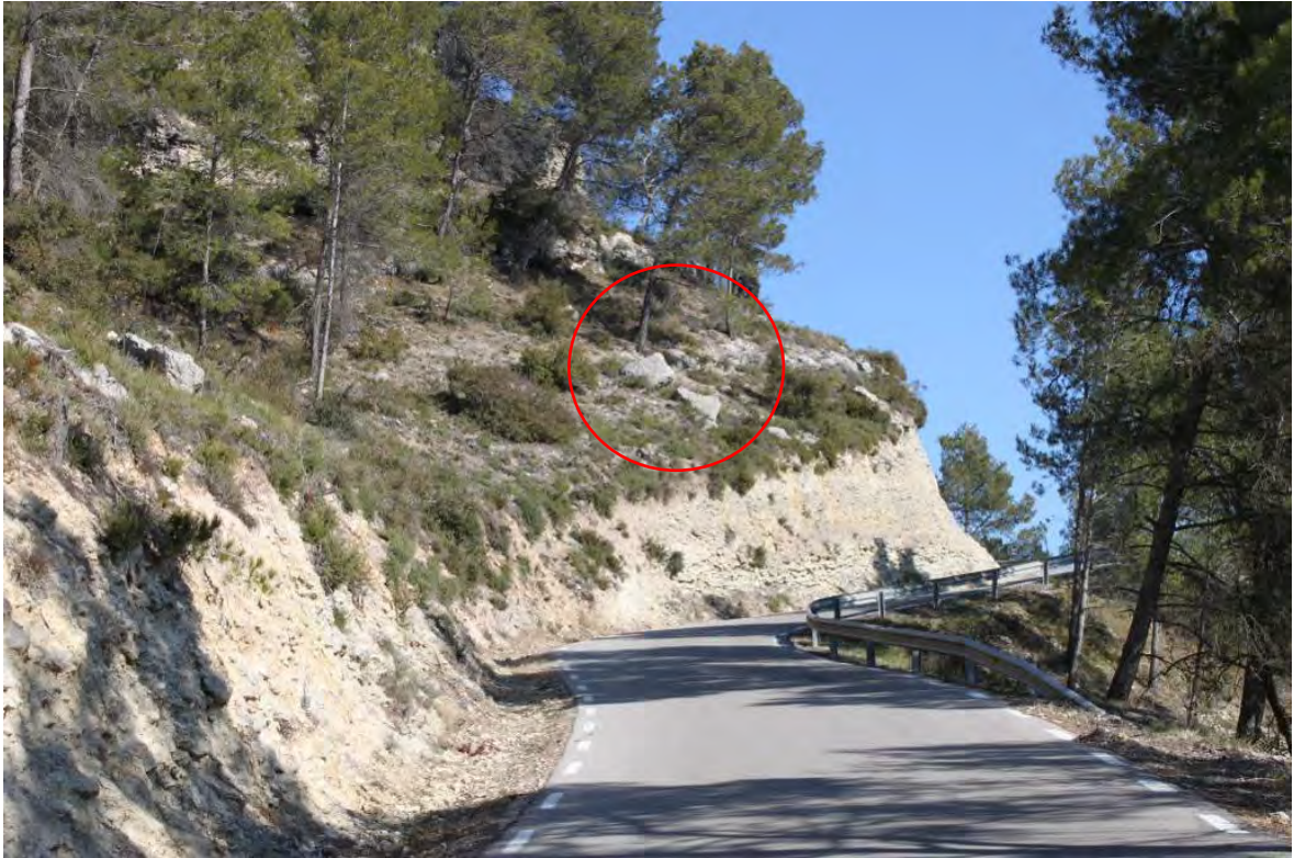
Fotografia 19: carretera d'accés a la carretera BV-2204 blocs despresos sobre el vessant (cercle vermell).
